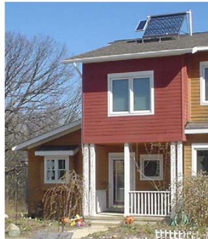
Obrázok 30.2 Solárne tepelné kolektory, ktoré zabezpečujú prípravu teplej vody pre rodinu v Michigane. Obehové čerpadlo systému poháňa elektrina z malého fotovoltaického panelu naľavo.
