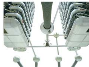
Obrázok 25.13 Vysokonapäťové zariadenie jednosmerného prúdu v Číne. Fotografia: ABB.
