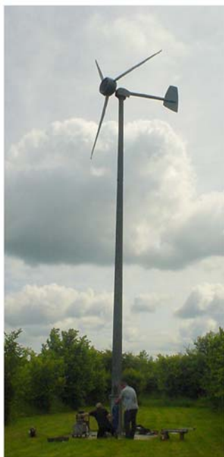
Obrázok B.10 Turbína Iskra s výkonom 5 kW a priemerom 5,5 pri ročnej revízii [www.iskrawind.com]. Táto turbína umiestnená v Hertfordshire (ktorý nepatrí medzi najveternejšie lokality vo Veľkej Británii), s výškou 12 m priemerne vyrobí 11 kWh za deň. Veterný park s turbínami s takouto výrobou s plochou 30 m × 30 m by mal koncentráciu výkonu 0,5 W/m 2 .
