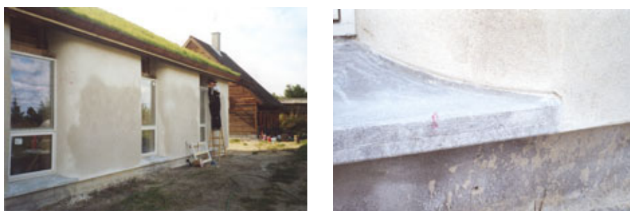
Figur 32. Ungdomsboliger i Torup, Nordsjælland. Her er buede udvendige vindueslysninger medvirkende til godt lysindtag. Den støbte betonsølbænk og opkanten langs med den buede vindueslysning beskytter pudsen mod fugt.
