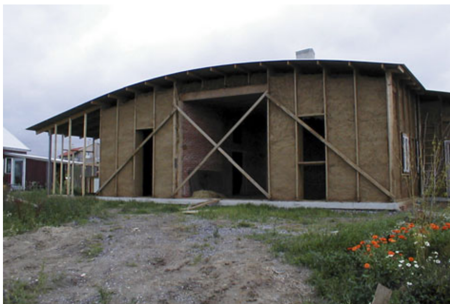
Figur 2. Halmhus i Herskind ved Århus under opbygning. Her ses det bærende træskelet udfyldt med halmballer. Afstivning af gavle er midlertidig. (Foto: Lars Keller).
