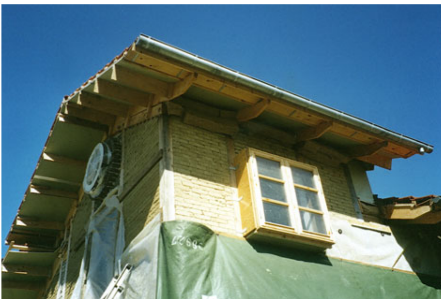
Figur 4. Halmhus i Torup. Bagmuren er opbygget som en bindingsværkskonstruktion udfyldt med lersten. Udvendig er efterfølgende isoleret med halmballer. Indvendig lerpudset og udvendig pudset med kalkcementmørtel.
