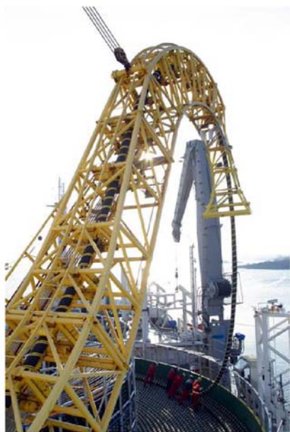
Obrázok 25.7 Ukladanie vysokonapäťového DC spojenia medzi Fínskom a Estónskom. Dvojica týchto káblov prenáša výkon 350 MW. Fotografia: ABB.
