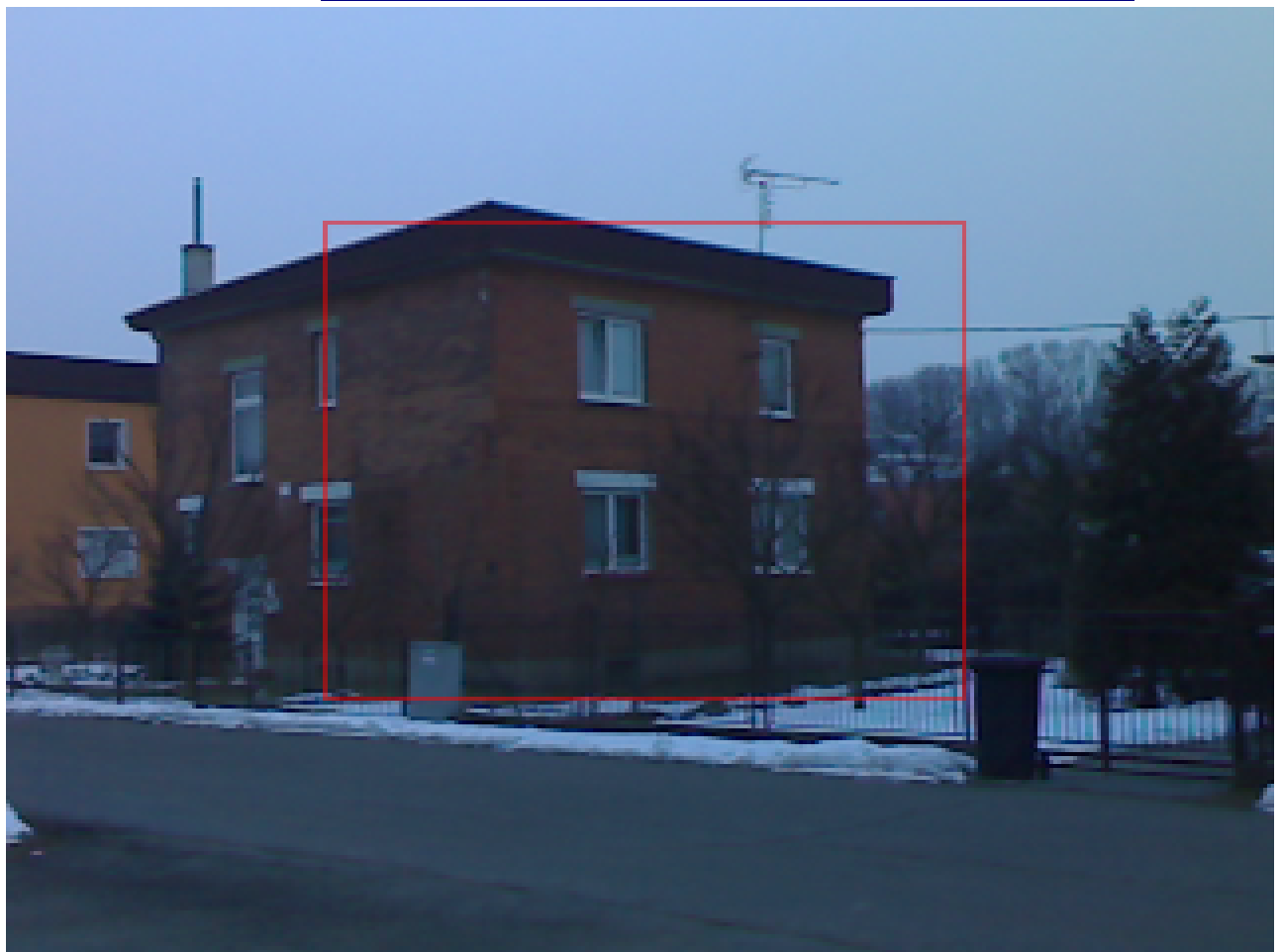
Zde je zajímavý rozdíl mezi dvěma zdmi domu, ta přední izoluje zvláště špatně. Nápadné je pootevřené okno.
