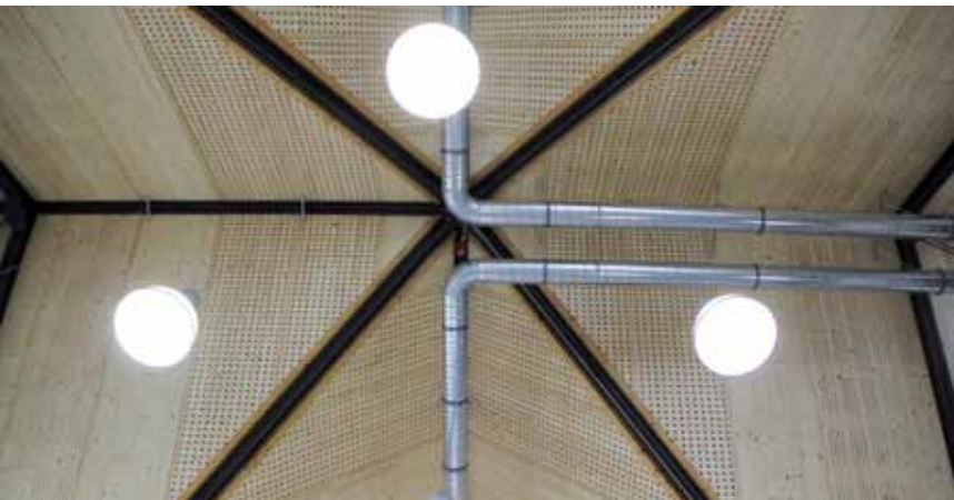
Lüftung mit Wärmerückgewinnung
