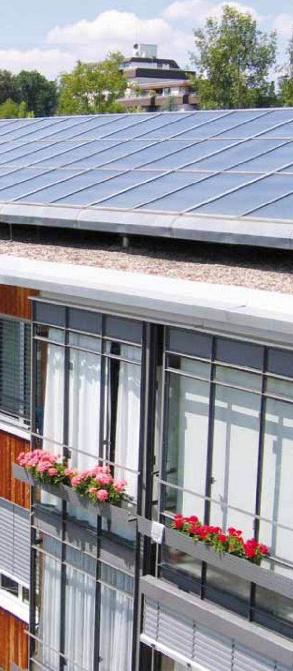
Thermische Solaranlage zur Warmwasserbereitung
