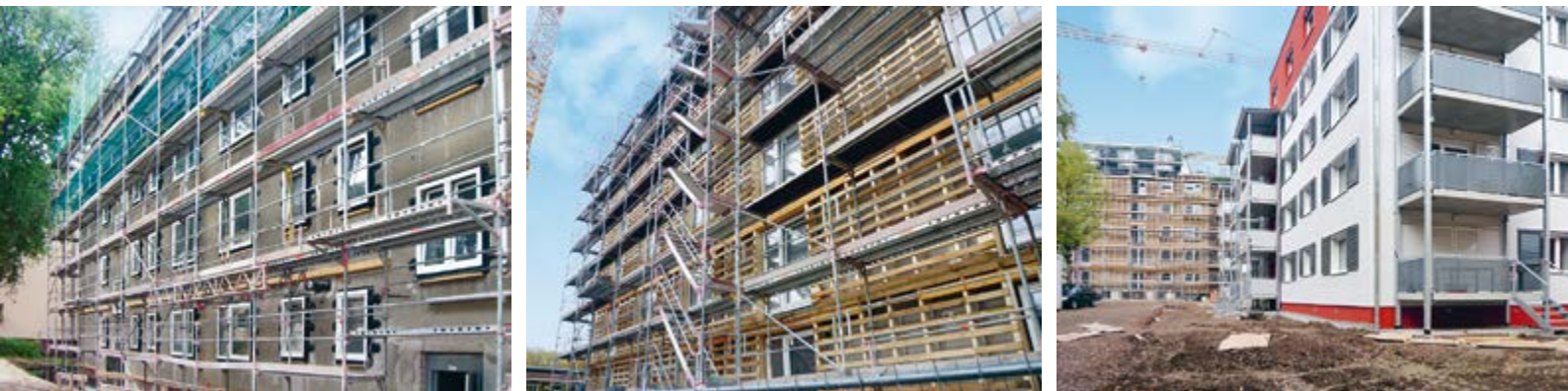
Rotlintstraße, Frankfurt am Main, Einbau von Fenstern, Lüftungsanlage und Holzschalung für Zellulosedämmung
