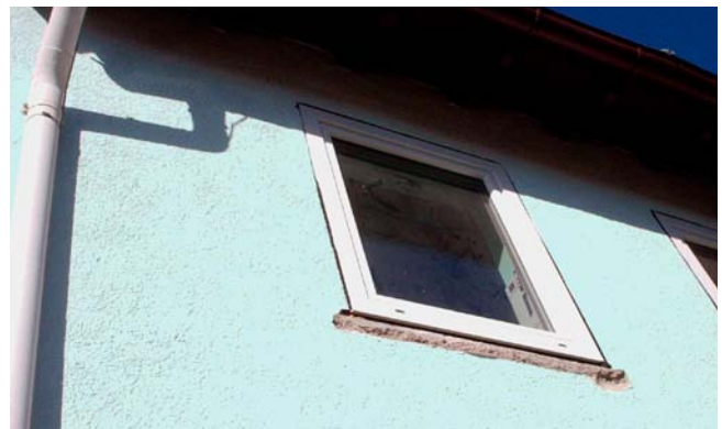
So ist die Fassade ideal für das Aufbringen der Dämmung vorbereitet: Die neuen Wärmeschutzfenster sind außenbündig eingebaut und die Kanten der alten Fensterbänke wurden abgestemmt.
