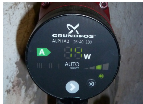
Abbildung 27: Hocheffizienzpumpe. Die Leistungsanpassung erfolgt kontinuierlich über einen Permanentmagnetmotor und Differenzdruckregelung. Die Leistungsaufnahme der dargestellten Pumpe beträgt aktuell 14 W.
