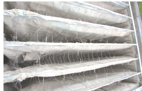
Foto: Achim Hering, CC BY-SA 3.0, via Wikimedia Commons Abbildung 33: Verschmutzter Filter einer Lüftungsanlage.
