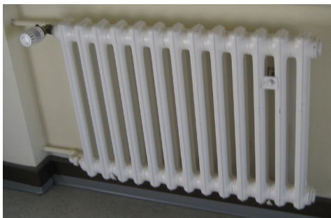
Foto: Fraunhofer IBP, Andrea Schneider Abbildung 16: Gliederheizkörper
