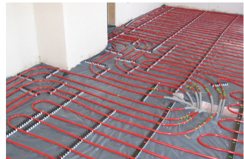
Foto: H. Raab, CC BY-SA 3.0, via Wikimedia Commons Abbildung 18: Fußbodenheizung
