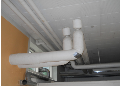
Foto: EPO, Public Domain, via Wikimedia Commons Abbildung 23: Fehlstellen in der Dämmung von Rohrleitungen
