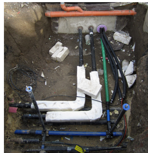
Foto: Cschirp, CC BY-SA 3.0, via Wikimedia Commons Abbildung 47: Hausanschluss mit Fernwärme sowie Wasser, Telefon, Strom und Glasfaser per Mehrspartenanschluss.
