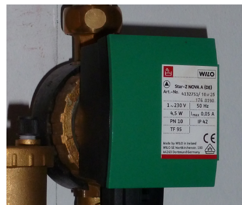
Foto: Fraunhofer IBP, Andrea Schneider Abbildung 28: Zirkulationspumpe mit geringer Leistungsaufnahme von 4,5 W.
