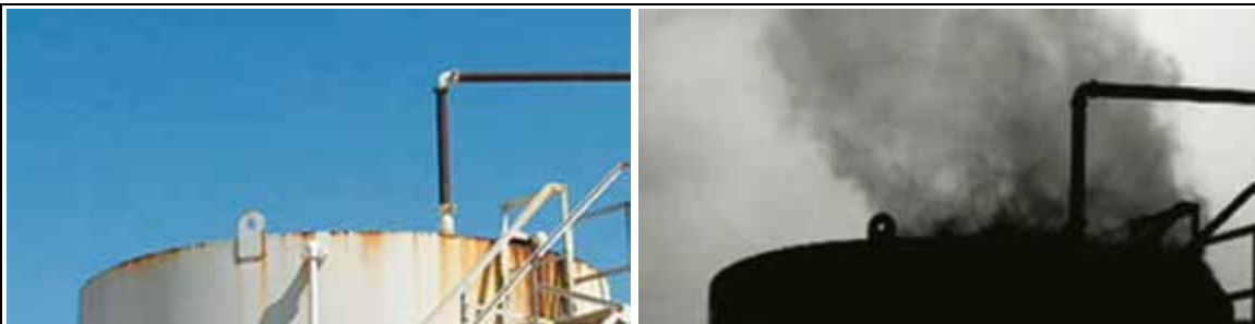
Pouhým okem nejsou vidět žádné emise z nádrže na skladování ropy (vlevo), ale s pomocí infračervené kamery je unikající \text{CH}_4 zřetelný (vpravo). Zdroj: US EPA
