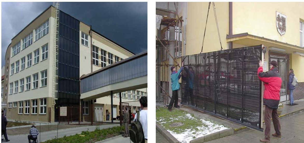
obr. 15. Velkoplošný fasádní solární kolektor na SPŠ Břeclav
