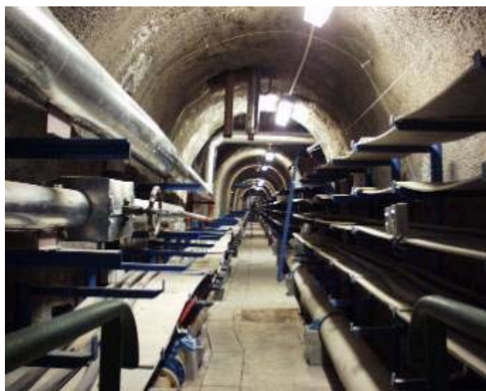
obr. 11. Podzemní vedení sítí v kolektoru
