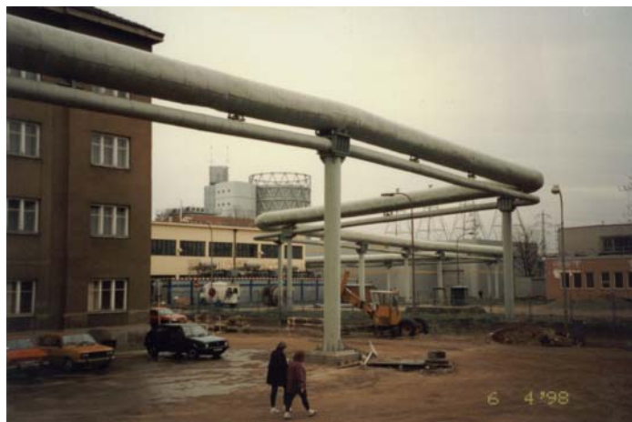
obr. 8. Nadzemní tepelné sítě
