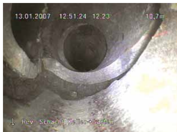
Schäden am Kanal durch Lagerversatz.
