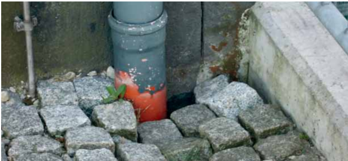
Absackung im Bereich eines Fallrohres.
