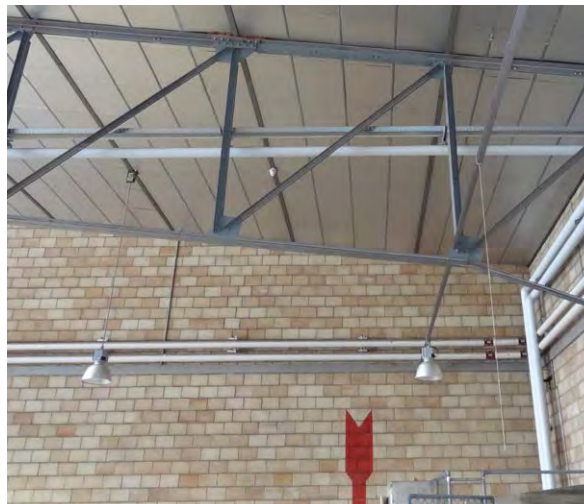
Flugplatz Emmen, Flugzeughalle 1, 1938, bauzeitliche Vormauerung der Betonaussenwand mit Tonisolierplatten zur Vermeidung von Kondensaten (Abb. 50)
