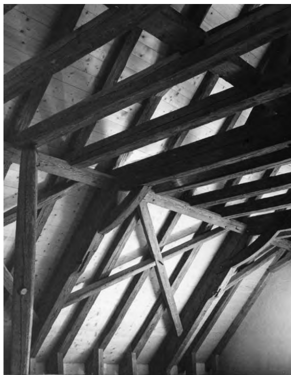
Wingreis (Gemeinde Twann) ehemaliges Thormanngut, um 1580/1624. Wertvoller Dachstuhl mit Brettunterdach (Abb. 96)
